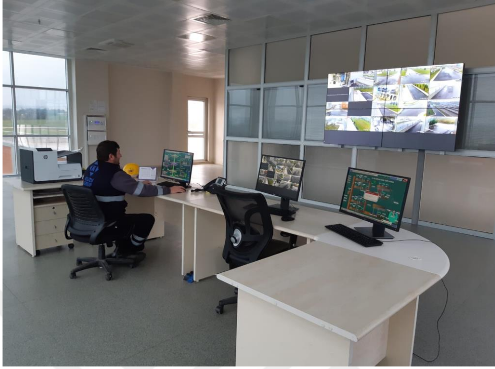
Resim 39. Selimpaşa İdari Bina SCADA Odası.
