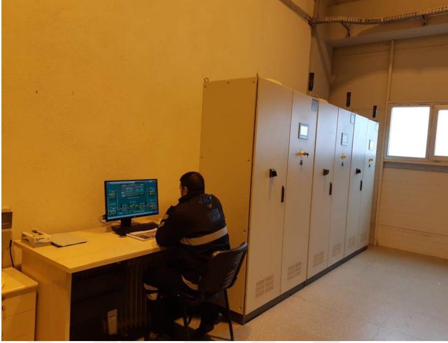
Resim 40. Selimpaşa Çamur SCADA Odası.
