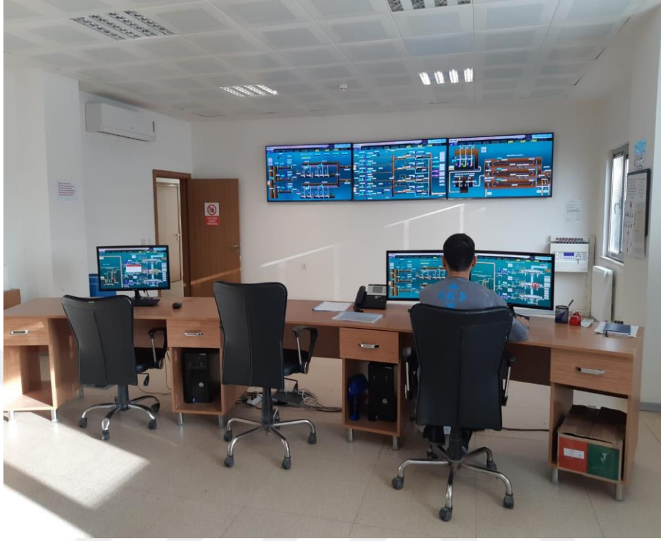
Resim 37. Silivri İdari Bina SCADA Odası.
