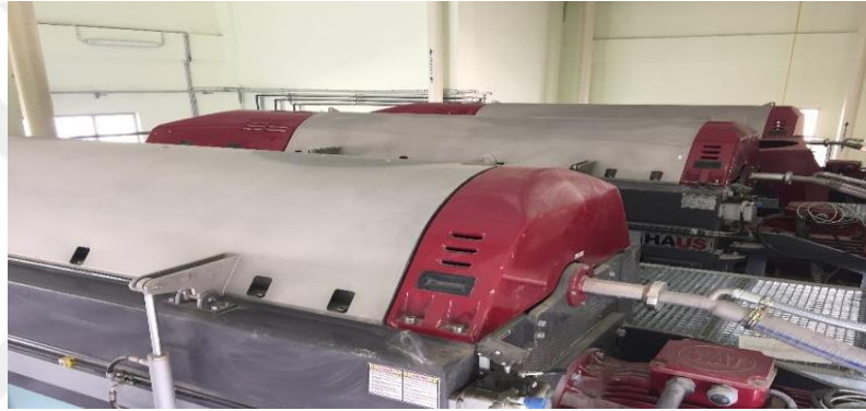
Resim 24. Silivri Tesisine ait Dekantörler.
