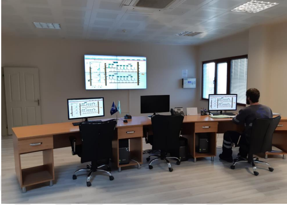
Resim 41. Çanta İdari Bina SCADA Odası.
