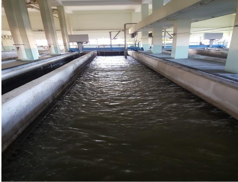
Resim 20. Silivri Kum - Yağ Tutucu Havuz
