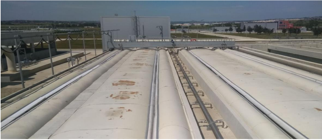
Resim 28. Selimpaşa Kum - Yağ Tutucu Havuzlar
