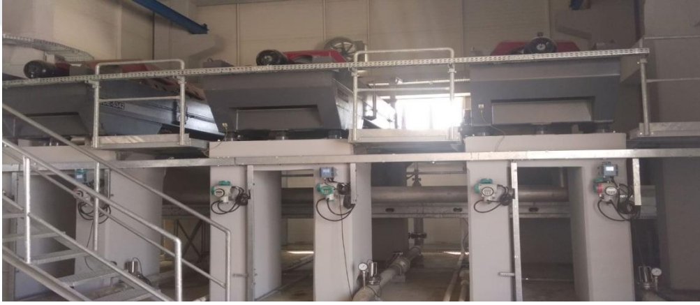
Resim 32. Selimpaşa Tesisine ait Dekantörler.
