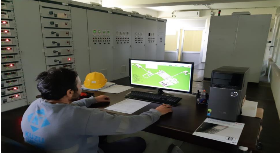
Resim 42. Çanta Çamur SCADA Odası.
