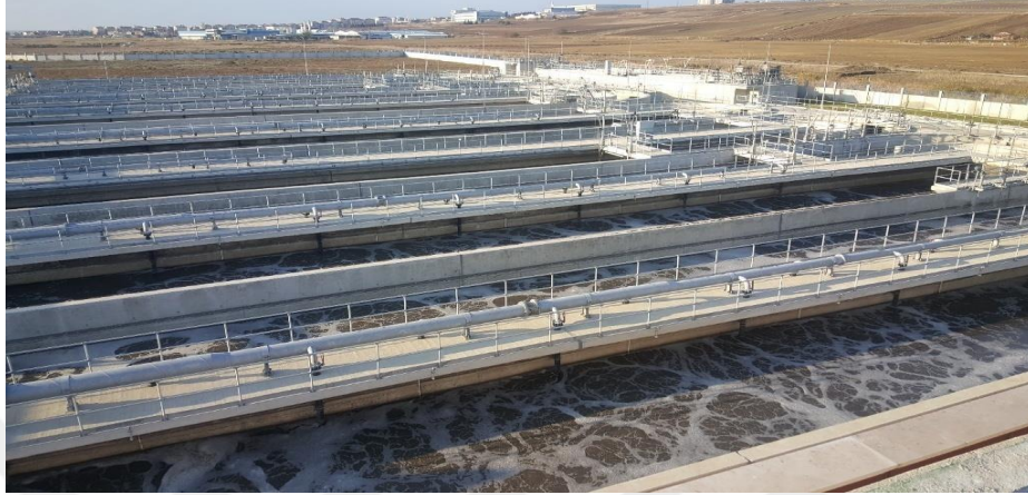
Resim 22. Silivri Proses Havuzları
