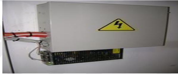
Şekil 5.1. Duvara Monte Edilen Adaptör Kablolarının Açıkta Olması
