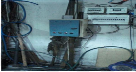
Şekil 5. 22. Tedbir Alınmamış Elektrik Panosu
