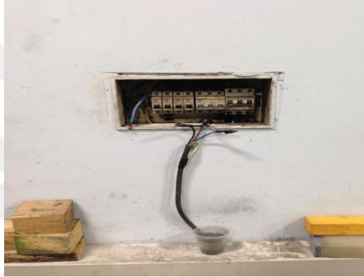
Şekil 5. 24. Açık Bırakılan Sigorta Kutusu ve Bantla Yamanmış Elektrik Kablosu
