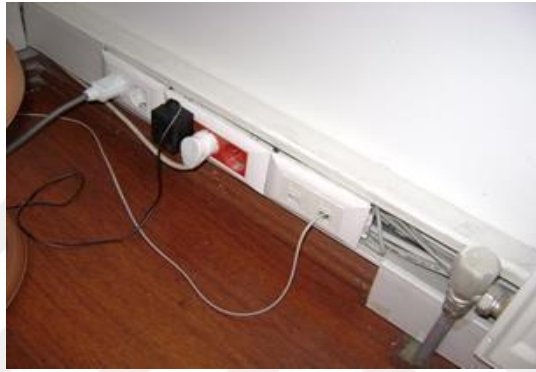
Şekil 5.5. Katlarda Dağınık Halde Bulunan Elektrik Kablo ve Prizler
