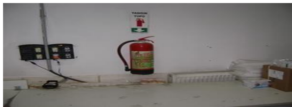
Şekil 5.2. Duvara Monte Edilen Yangın Tüpünün Yerinin Belirtilmemesi
