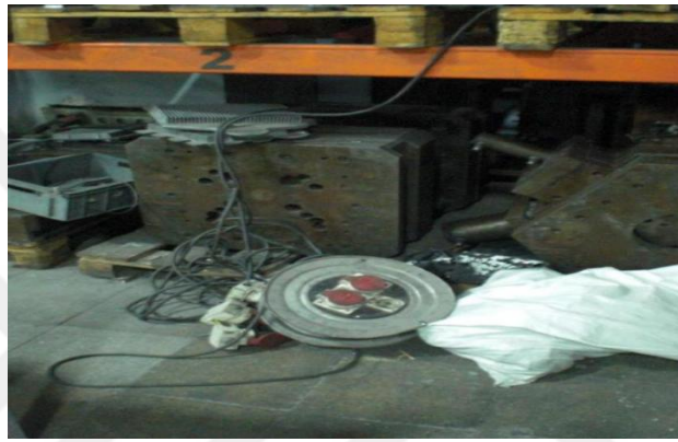
Şekil 5. 17. Dağınık Bırakılan Hasarlı Elektrik Uzatma Kabloları ve Çoklu Priz
