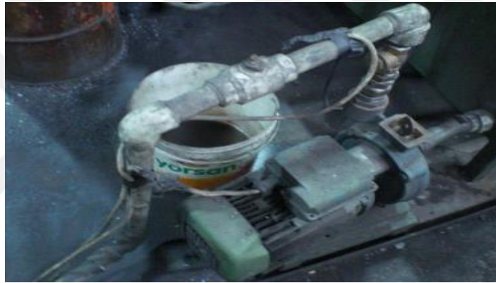
Şekil 5. 10. Elektrik Motorunda Bantla Yamanmış Elektrik Kablosu
