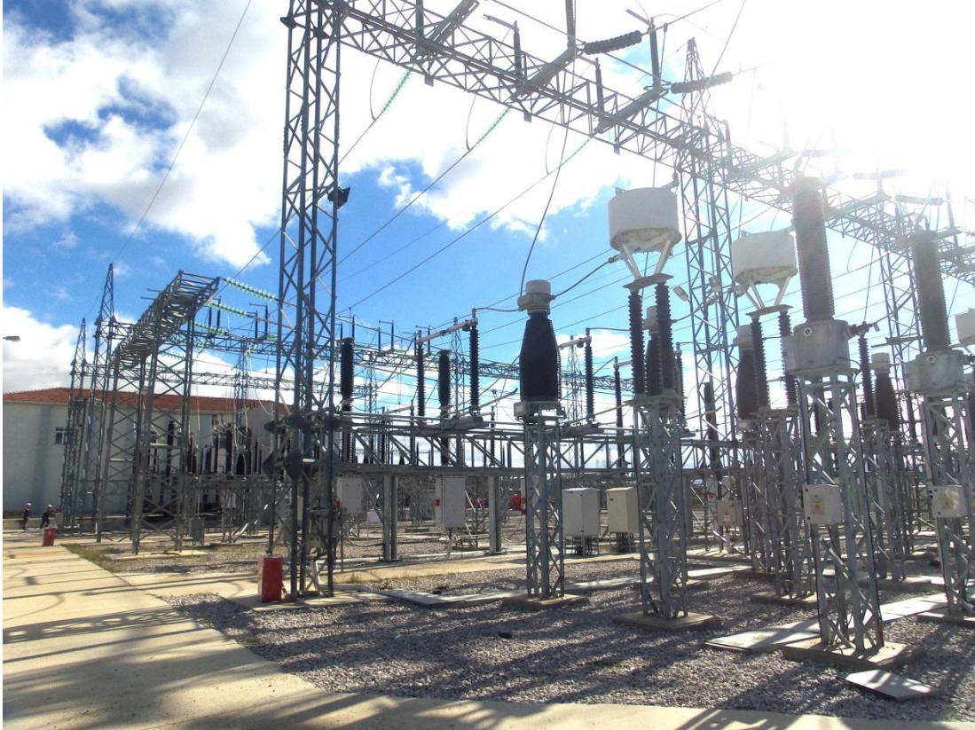
Resim 2. Açık şalt sahalı bir transformatör merkezinin genel görünümü
