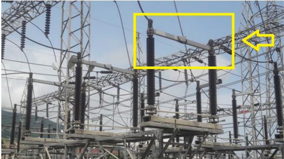
Resim 5. Açık şalt sahası içerisinde bulunan ayırıcı örneği
