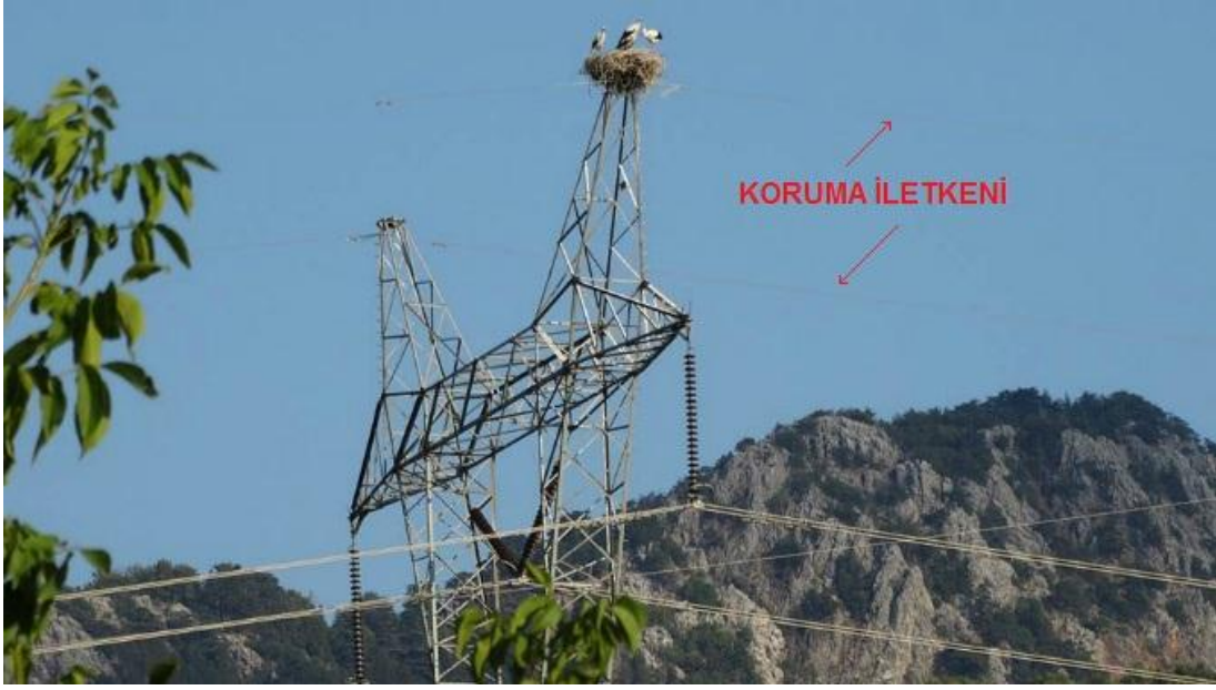
Resim 2.5. : Enerji İletim Elemanı Koruma Hattı
