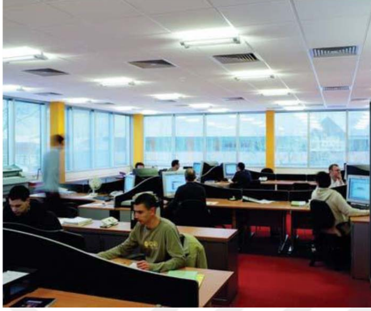
Şekil 4.4: Yarı endirekt aydınlatma armatürleri uygulaması yapılmış ofis (Alkan, 2010).
