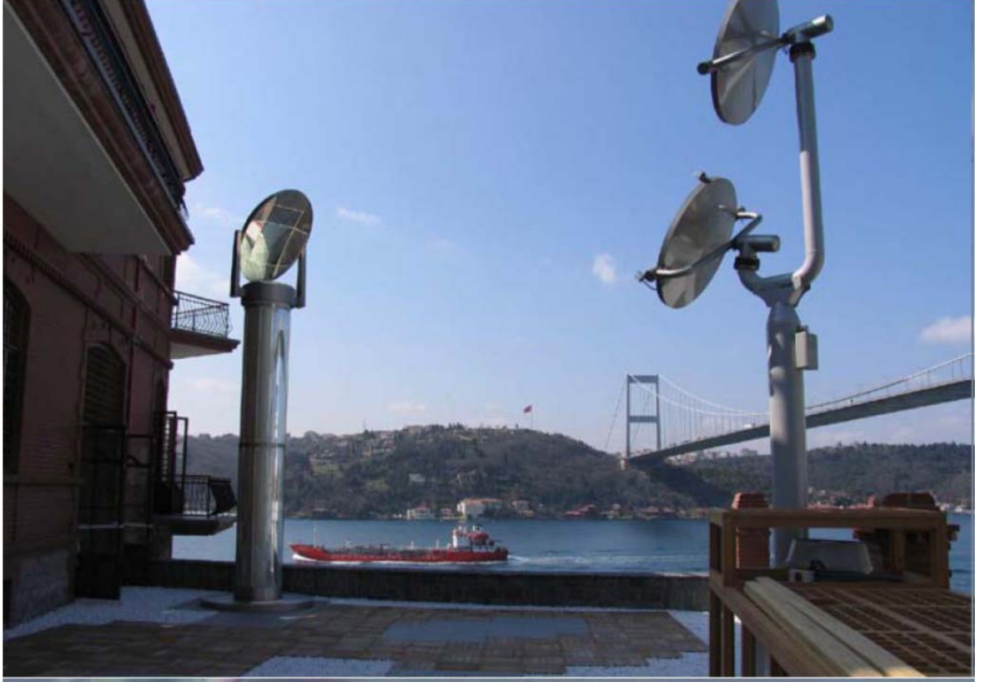
Şekil 4.18: Yusuf Ziya Paşa Köşkü (Perili Köşk) Borusan Holding Yönetim Binası heliostat uygulaması -İstanbul (OKUTAN, 2008).
