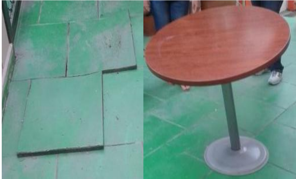
Şekil 6.2 : Zemin Taşlarının Yerinden Çıkması ve Masanın Ayağının Kırık Olması
