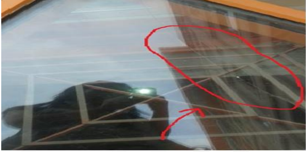
Şekil 6.1 : Spor Salonuna Bakan Camlarda Çatlama Nedeniyle Oluşan Risk
