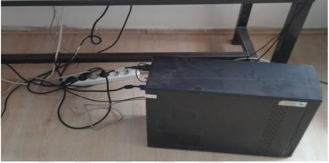
Şekil 6.5 : Elektrik Kablolarının Dağınık Olması ve Koruyucu İçerisinde Bulunmaması
