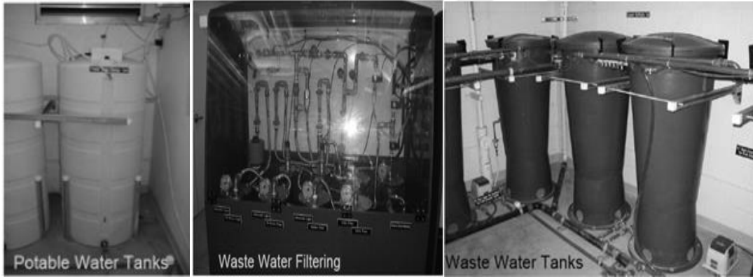
Şekil 5.6: Su Verimliliği; Yerde atık su arıtma: Grisu sistemi
