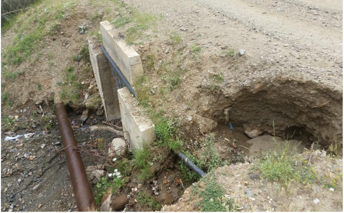
Şekil 8.4: Yetersiz kanat duvarı açıklığına sahip menfezde köy yolu imlasının göçmesi
