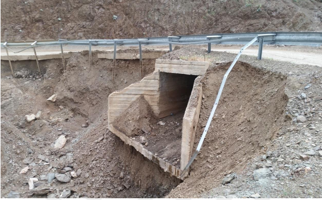
Şekil 8.1: Batman Sason Derince grup köy yolunda mansap tarafı erozyona uğrayan menfez
