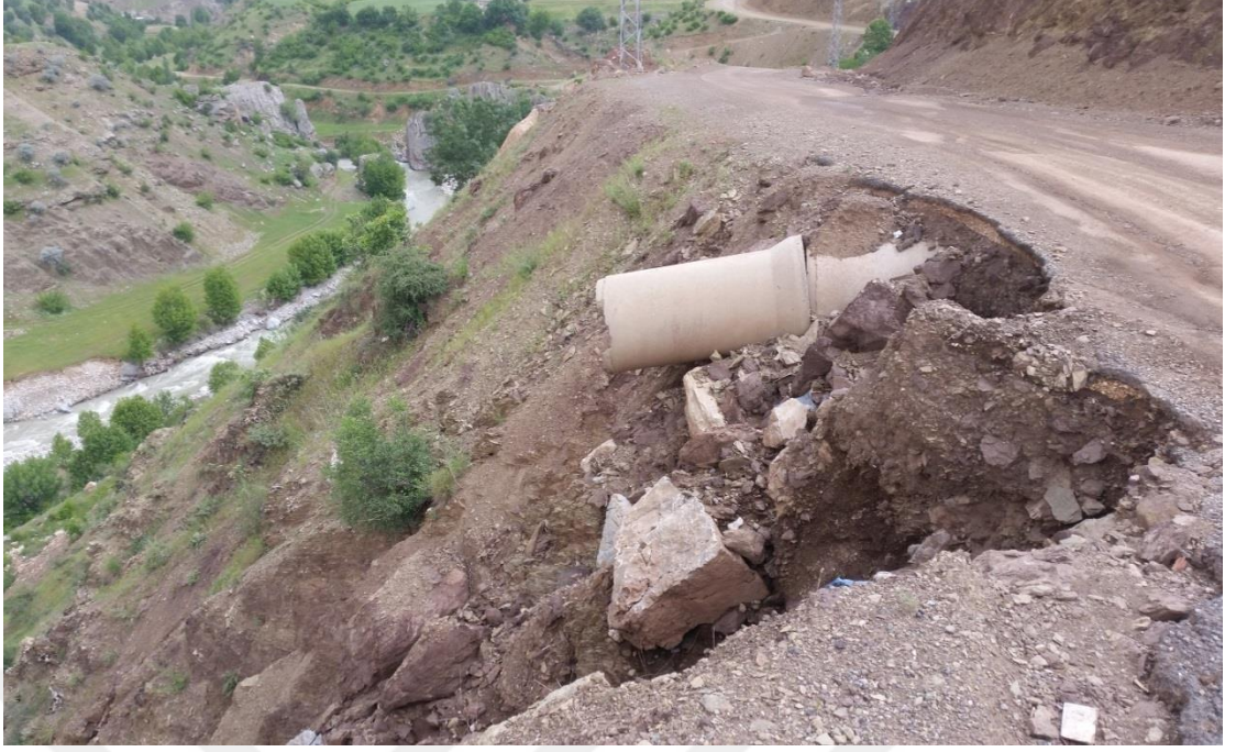
Şekil 8.6: Çıkış yapısı yapım eksikliğinden dolayı erozyona uğrayan büz noktası
