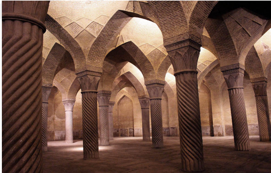
Şekil 3.29: Panam genel olarak yalıtım anlamına gelmektedir ve tavanda kabuk olarak işlevlenir. Güneş ışınlarını engelliyor ve görsel açısından yapıya değer katıyor.
