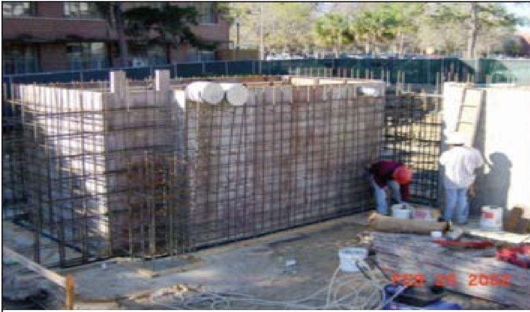
Şekil 1.1: Florida Üniversitesi'nde Rinker Hall yağmur suyu toplama sistemi
