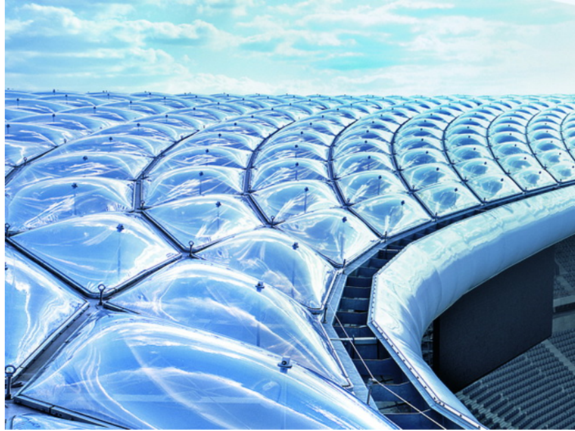
Şekil 6.19: Allianz Arena Çatı ETFE Yastıkları [Url-117]
