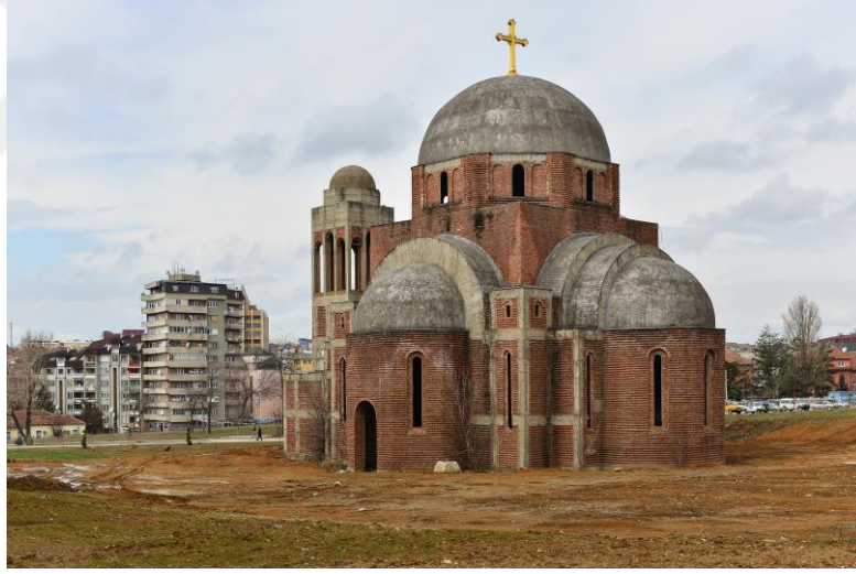
Görsel 8.22. Savaş-sonrası ziyarete kapalı ve âtıl halde varlıklarını sürdüren Kosova'daki Sırp yapımı ve/veya Yugoslav dönemi anıt ve yapılarına örnekler: Priştine Üniversitesi Merkez Kampüsü arsası içinde yer alan 1990'lar yapımı "Aziz George Sırp Ortodoks Kilisesi".
