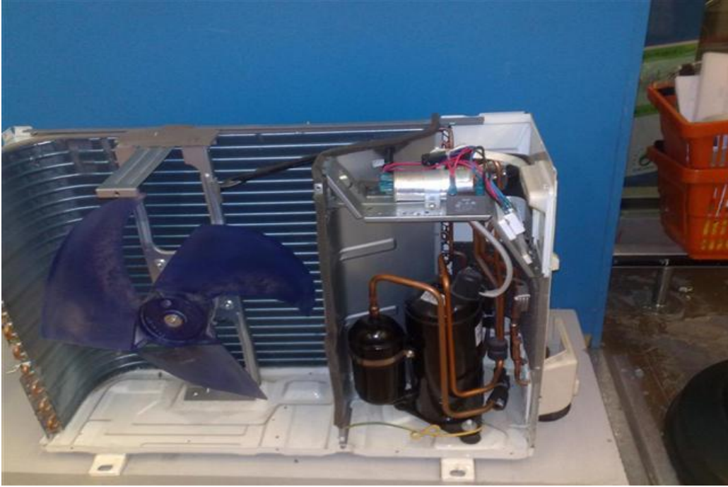
Şekil 3.5: Split klima dış ünitesi
