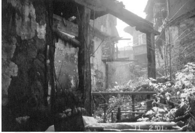
Şekil 2.20: Cumalıkızık geleneksel evlerindeki strüktürel bozulmalar
