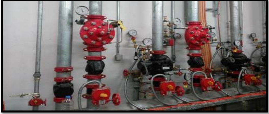
Şekil 5.12. Yangından Korunma Sistemi Vanaları
