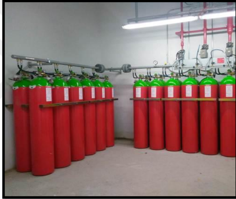
Şekil 5.13. Gazlı Yangın Söndürme Tüpleri
