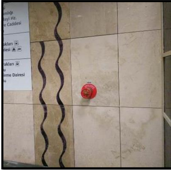
Şekil 5.11. Yangın Vanası İtfaiye Bağlantı Ağzı
