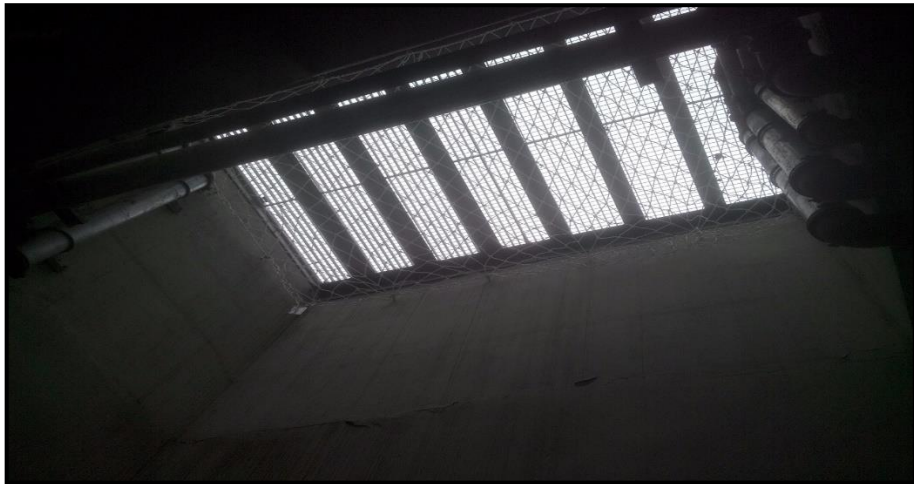
Şekil 7.7. Havalandırma Şaftı Mazgalı Altı Yaşam Ağı
