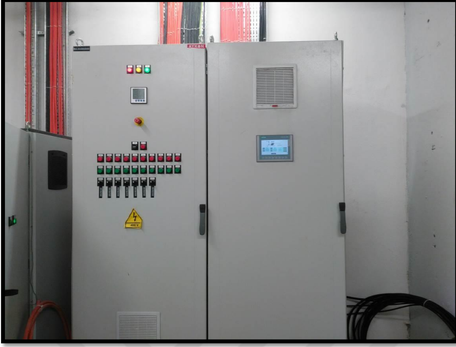
Şekil 5.15. AG Elektrik Panosu
