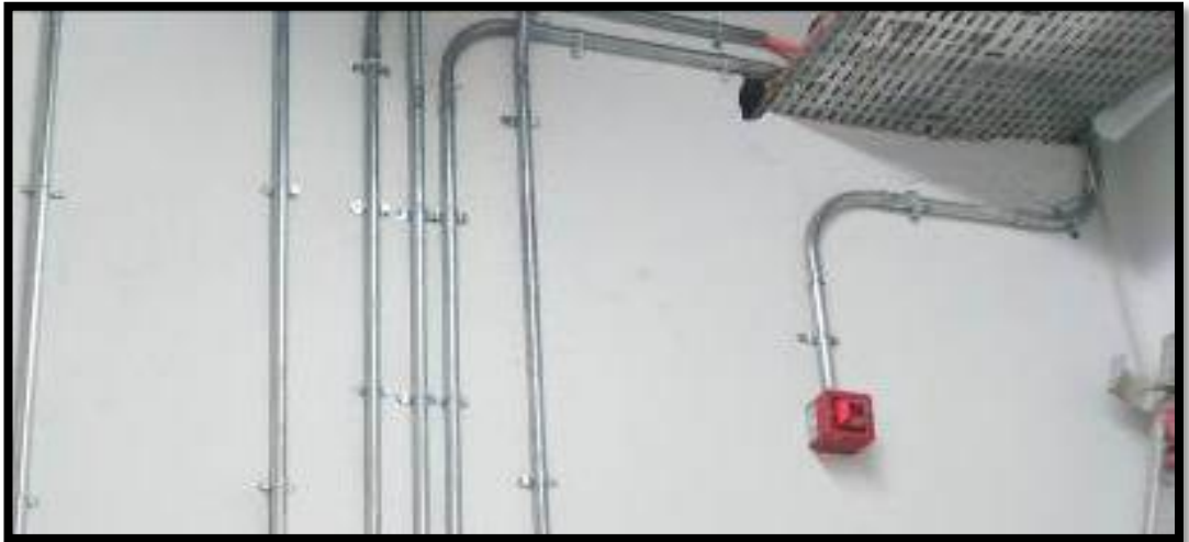
Şekil 5.7. Yangın alarm flaşörü
