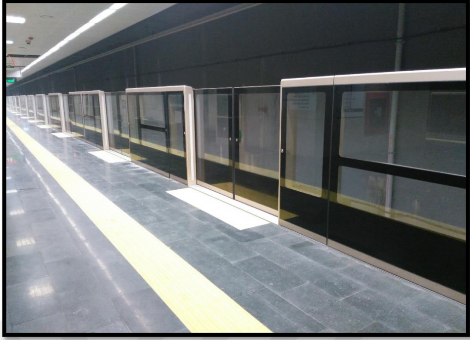
Şekil 5.17. Peron Ayırıcı Kapı Sistemi
