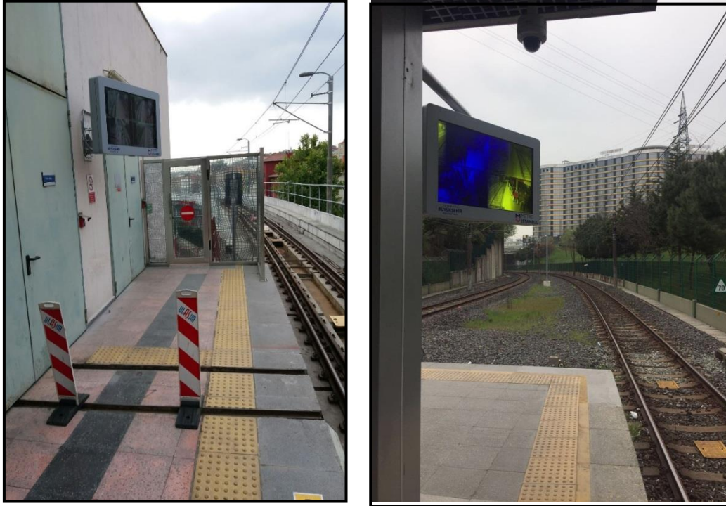
Şekil 7.4. Perona Monitör Sistemi Uygulamaları
