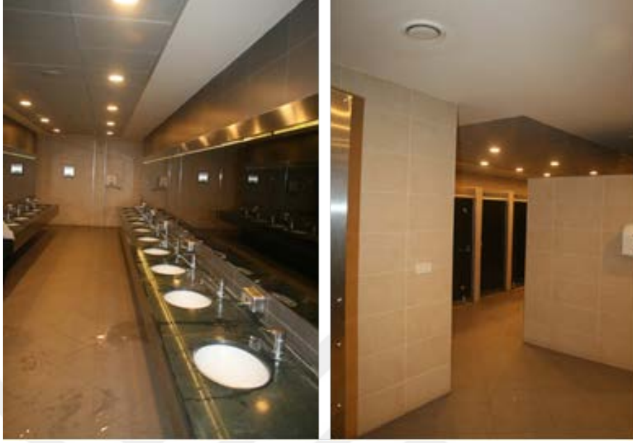
Şekil 0.187: Marmara İlahiyat Cami wc şadırvanlar
