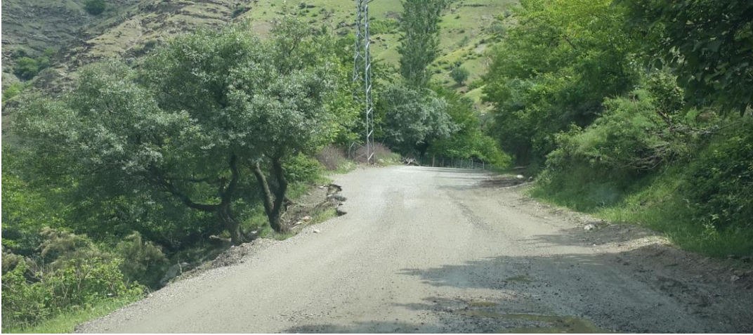
Şekil 6.38: Sason-Derince Grup Köy yolu 2018 yılı Asfalt Kaplama Yolda Toprak Kayması Sonucu Yol Durumu
