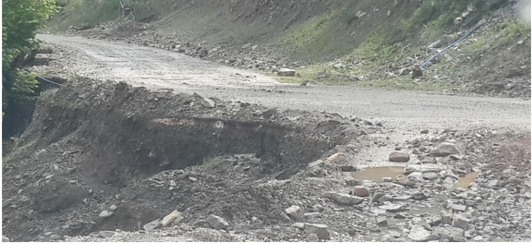
Şekil 6.41: Sason-Derince Grup Köy yolu 2018 yılı Asfalt Kaplama Yolda Gerekli Sanat Yapıları Yapılmaması Sonucu Yol Durumu
