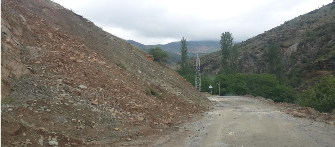
Şekil6.40 Sason-Derince Grup Köy yolu 2018 yılı Asfalt Kaplama Yolda Toprak Kayması Sonucu Yol Durumu
