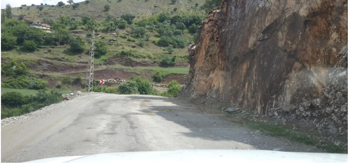
Şekil 6.35: Sason-Derince Grup Köy yolu 2018 yılı Asfalt Kaplama Yolda Yol Genişletme Yetersizliği Durumu
