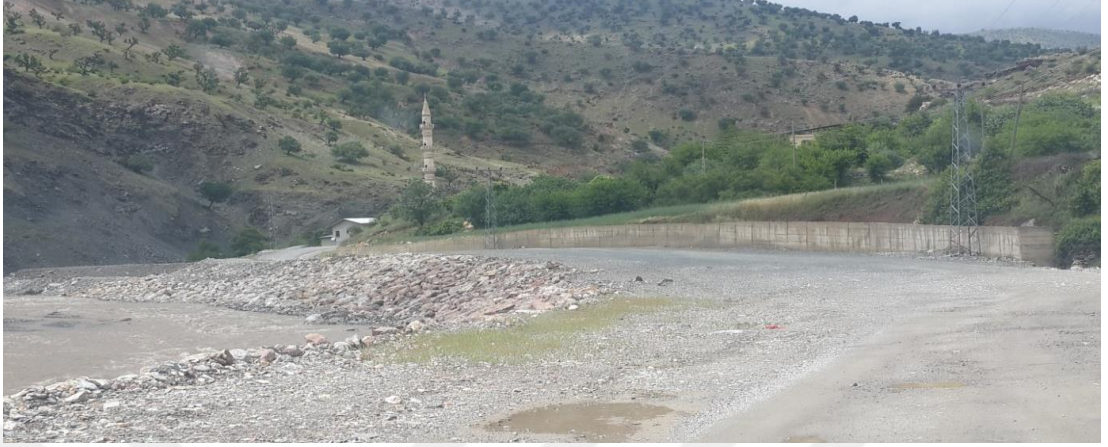
Şekil 6.39: Sason-Derince Grup Köy yolu 2018 yılı Dere Taşkını Sonucu Asfalt Kaplama Yol Durumu
