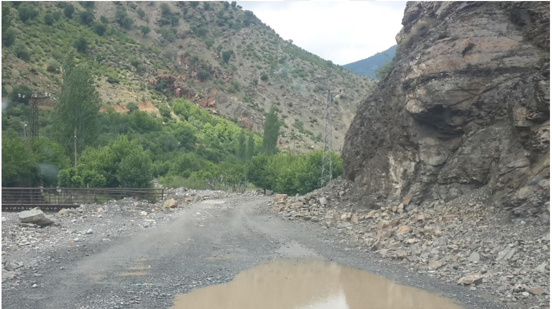
Şekil 6.40: Sason-Derince Grup Köy yolu 2018 yılı Asfalt Kaplama Yolda Yol Çökmesi Sonucu Yol Durumu
