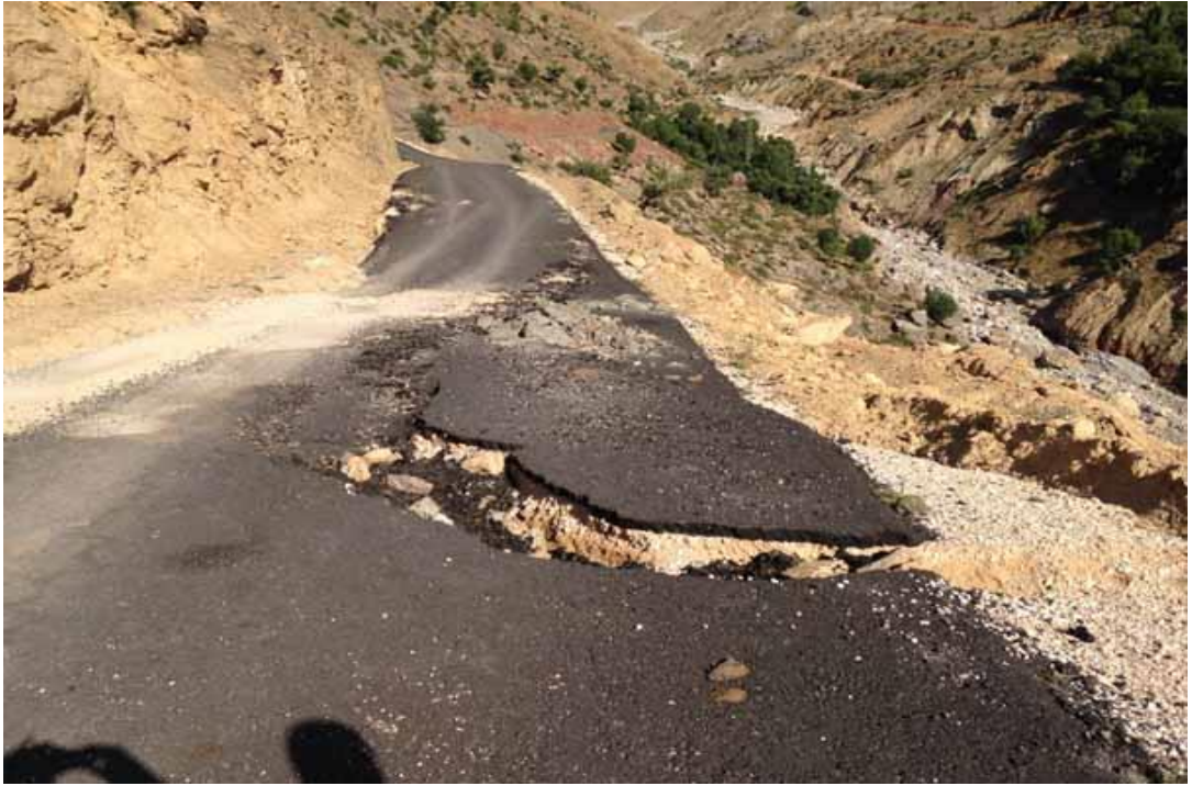
Şekil 6.33:. Sason-Derince Grup Köy yolu Toprak kayması sonucu Yol Durumu
