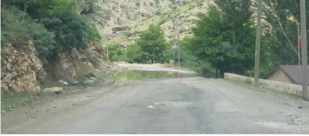
Şekil 6.41: Sason-Derince Grup Köy yolu 2018 yılı Asfalt Kaplama Yolda Sel Geçiti Yapılmaması Sonucu Oluşan Bozukluk Durumu
