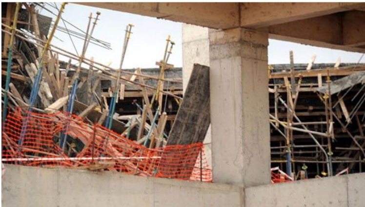
Şekil 4.19: Çökmüş bir iskele (www.sözcü.com.tr)
