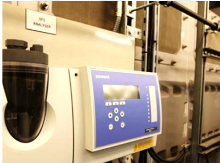
Şekil 2.8: Yağmur suyu arıtma sistemi (URL5)
