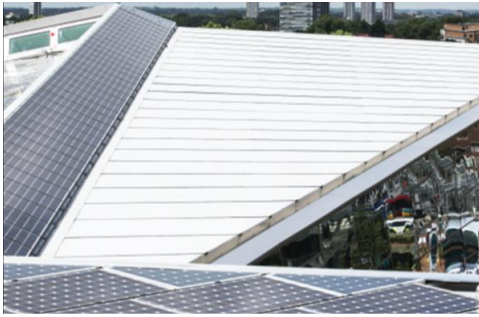
Şekil 2.4: Fotovoltaik güneş panelleri (URL1)
