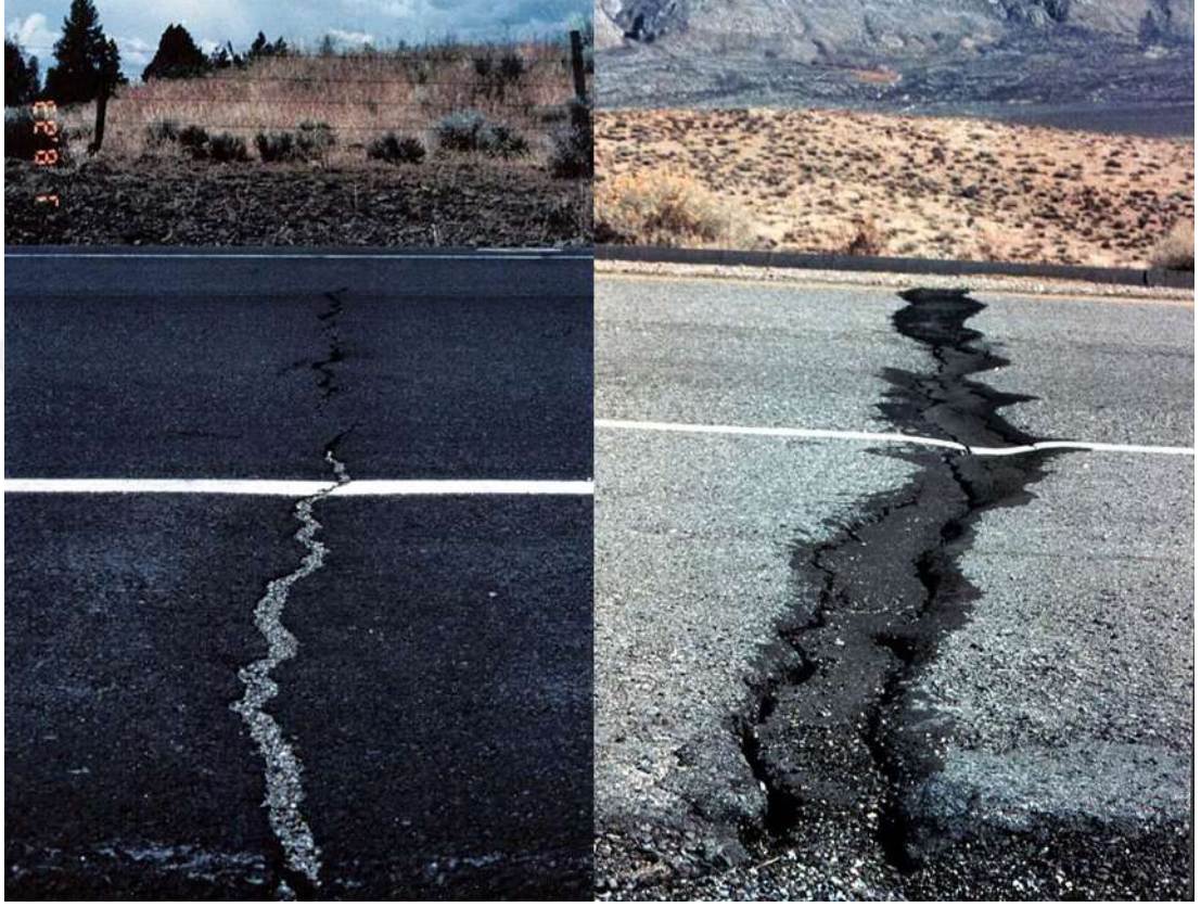
Şekil 2.3: Küçük ve Büyük enine çatlak
