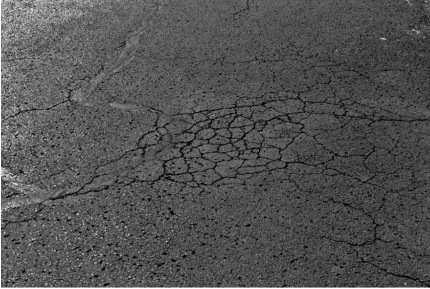
Şekil 2.4: Timsah sırtı çatlama
