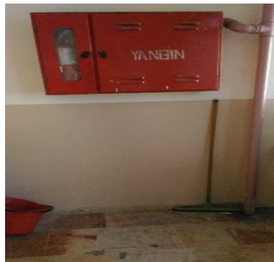
Şekil 3.15: Okullarda bulunan yangın dolapları
