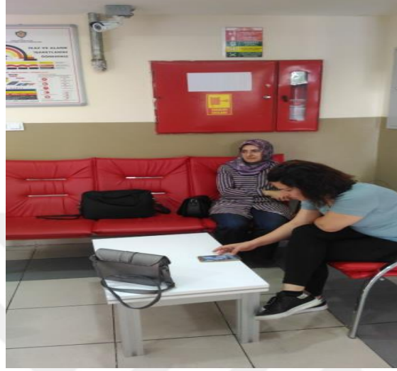
Şekil 3.16: Okullarda önünde malzeme bulunan yangın dolapları
