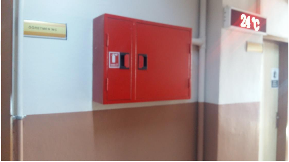
Şekil 2.2: Yangın söndürme tüpü ve hortumu
