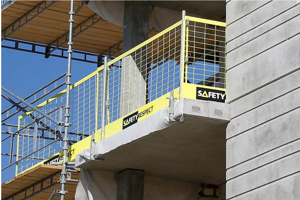
Şekil 7.19 : Balkon Kenar Koruması (SAFETY RESPECT, 2018)
