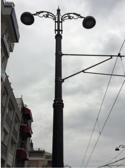
Şekil: 5.2.1. Çift yönlü aydınlatma elemanı (Elif GÜNER)
