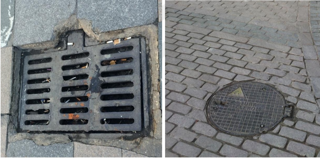
Şekil.5.67: Kanalizasyon ızgarası (Elif GÜNER) 5.68: Telekomünikasyon bakım kapağı (Elif GÜNER)
