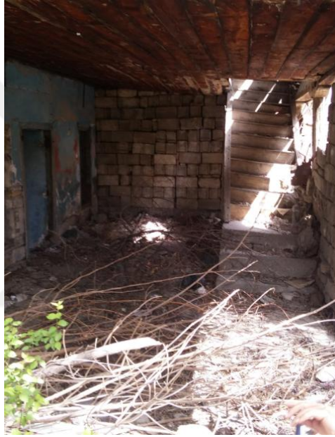
c. Beton kaideye oturan ahşap merdiven
