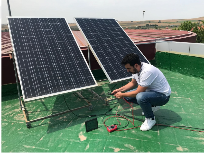
Şekil 3.1. Tepekent-İstanbulda Kurulu olan Güneş Panel Sistemi
