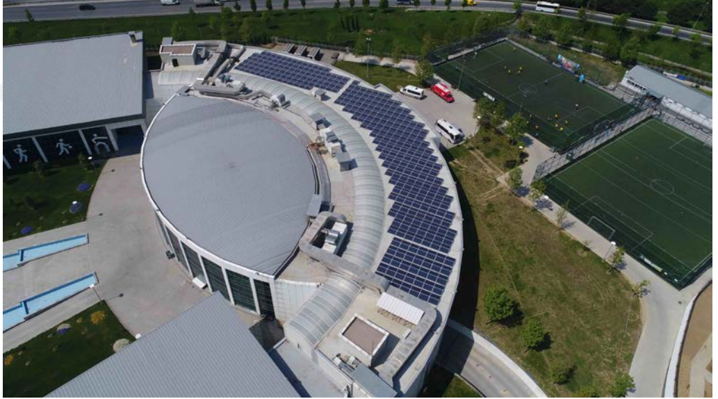
Şekil 3.1. İBB Hidayet Türkoğlu Spor Kompleksi Çatı Şebekeye Bağlı Güneş Enerji Santrali.
