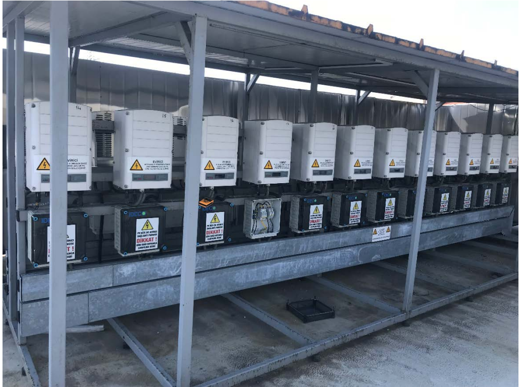
Şekil 3.51. Santral İnverter Bölümü
