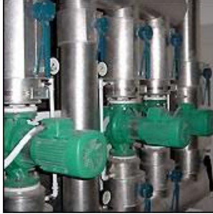
Resim 5.12. Polat Tower Arıtma Sistemi
