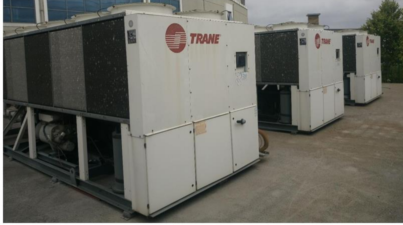
Şekil 2.18. Soğutma Grubu Genel Görünümü
