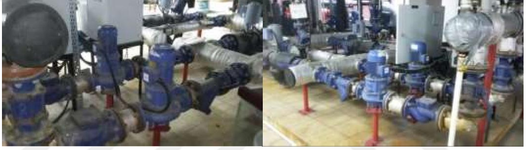
Şekil 2.59. Tesisatta Kullanılan Elektrik Motorları
