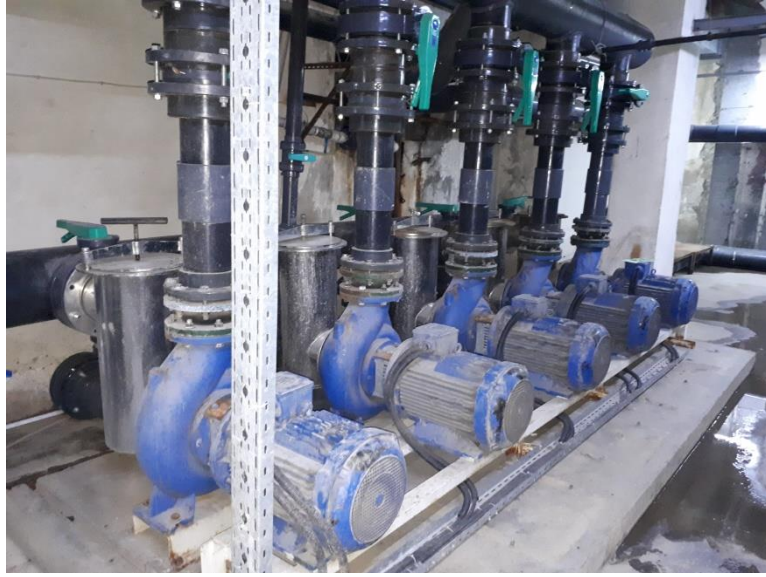
Şekil 2.111. Tesisatta Kullanılan Elektrik Motorları
