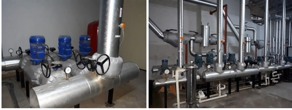
Şekil 2.109. Mekanik tesisat elemanları
