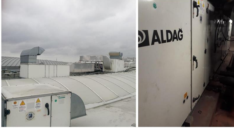
Şekil 2.15. Klima Santrali Genel Görünümü
