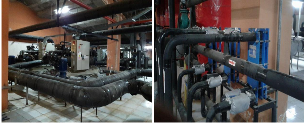
Şekil 2.33. Isıtma ve Soğutma Tesisat Görüntüleri
