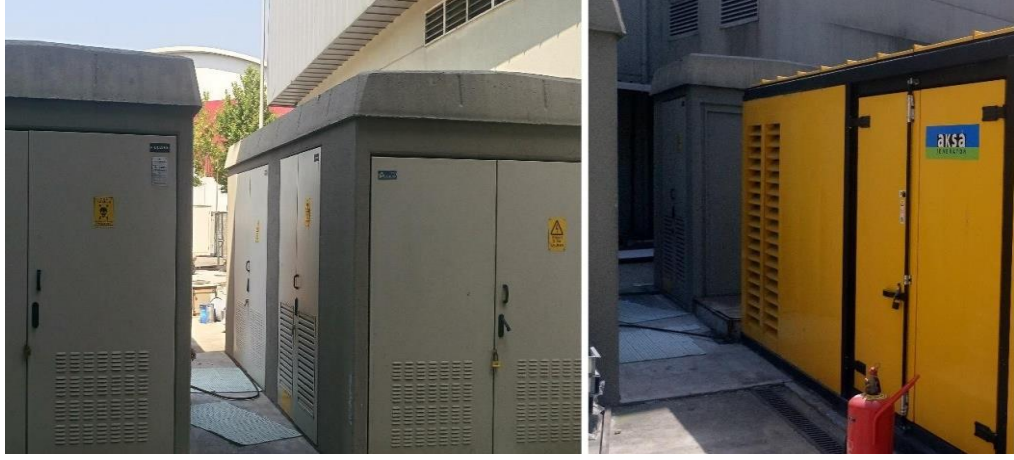
Şekil 2.20. Tesis Prefabrik Transförmötör Merkezi ve Jeneratör
