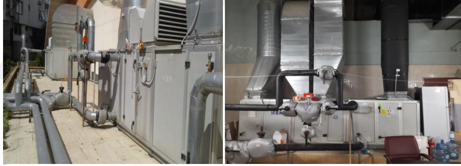
Şekil 2.31. Klima Santrali Genel Görünümü
