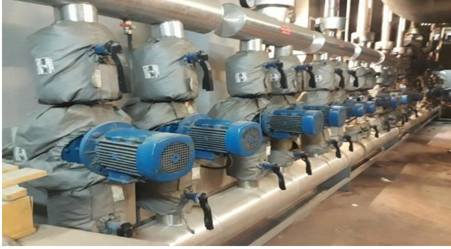
Şekil 2.21. Mekanik Tesisat Genel Görünüm
