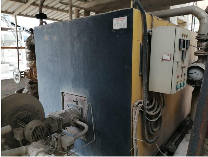
Şekil8.3. KızgınYağ Kazanı ( İSFALT AYDINLI 2020)
