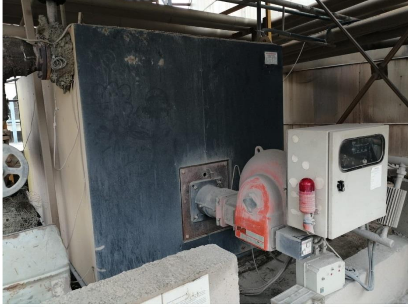
Şekil8.2. KızgınYağ Kazanı ( İSFALT AYDINLI 2020)
