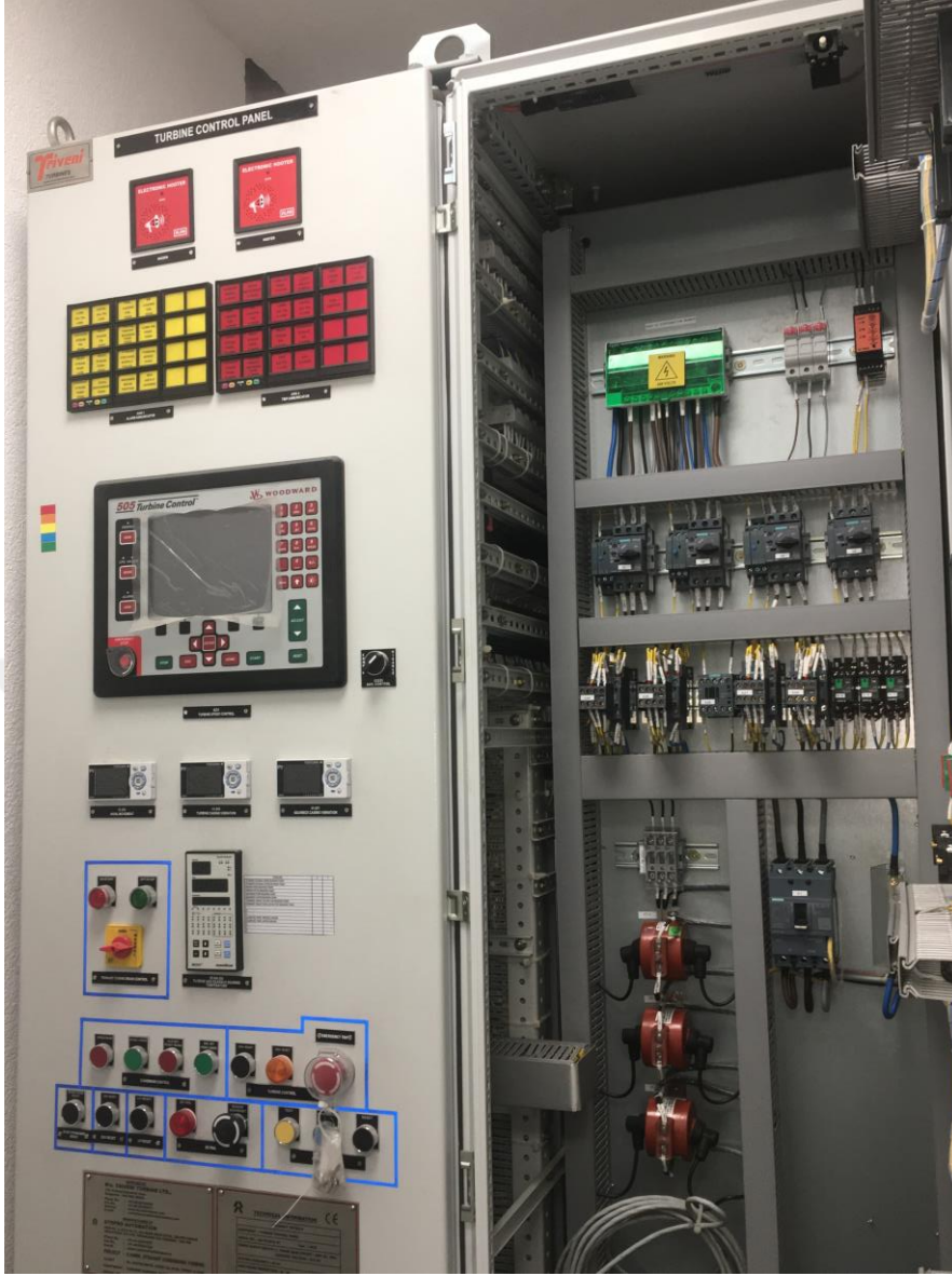
Şekil 6.22 Türbin kontrol panosu
