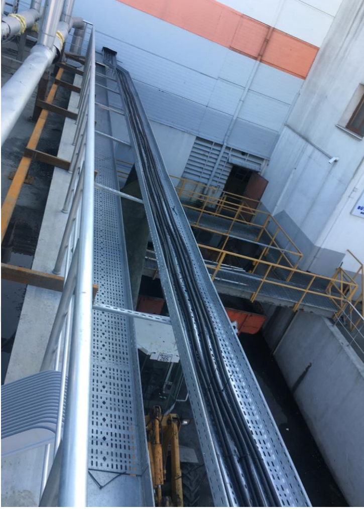
Şekil 6.27 Sinyal (sol) ve güç kablo tavaları (sağ)
