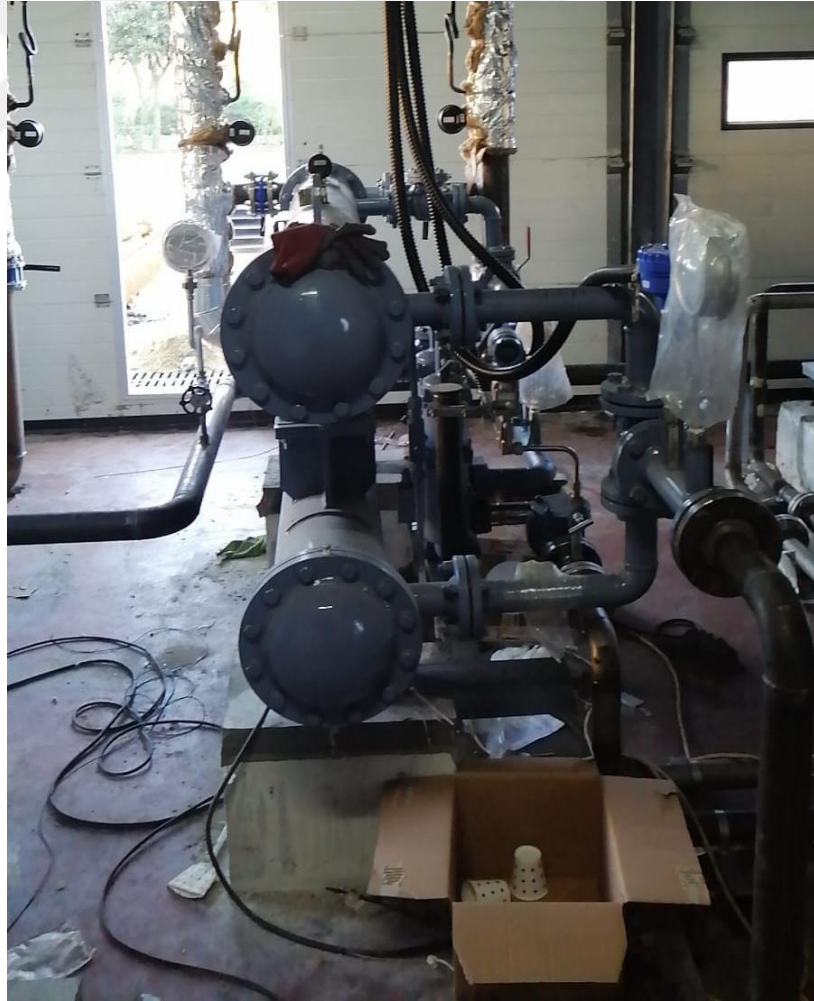
Şekil 6.14 Yağ soğutucu kondenser
