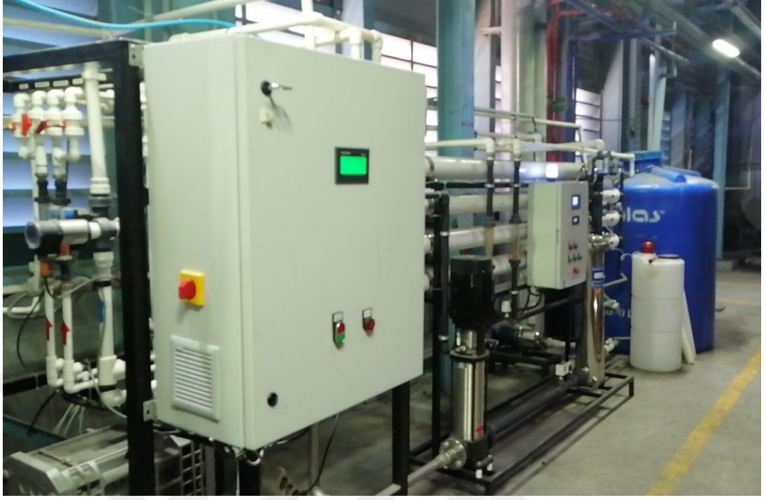
Şekil 6.10 Su arıtım üniteleri
