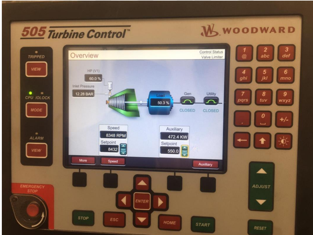
Şekil 7.2 Buhar Türbini Kontrol Paneli
