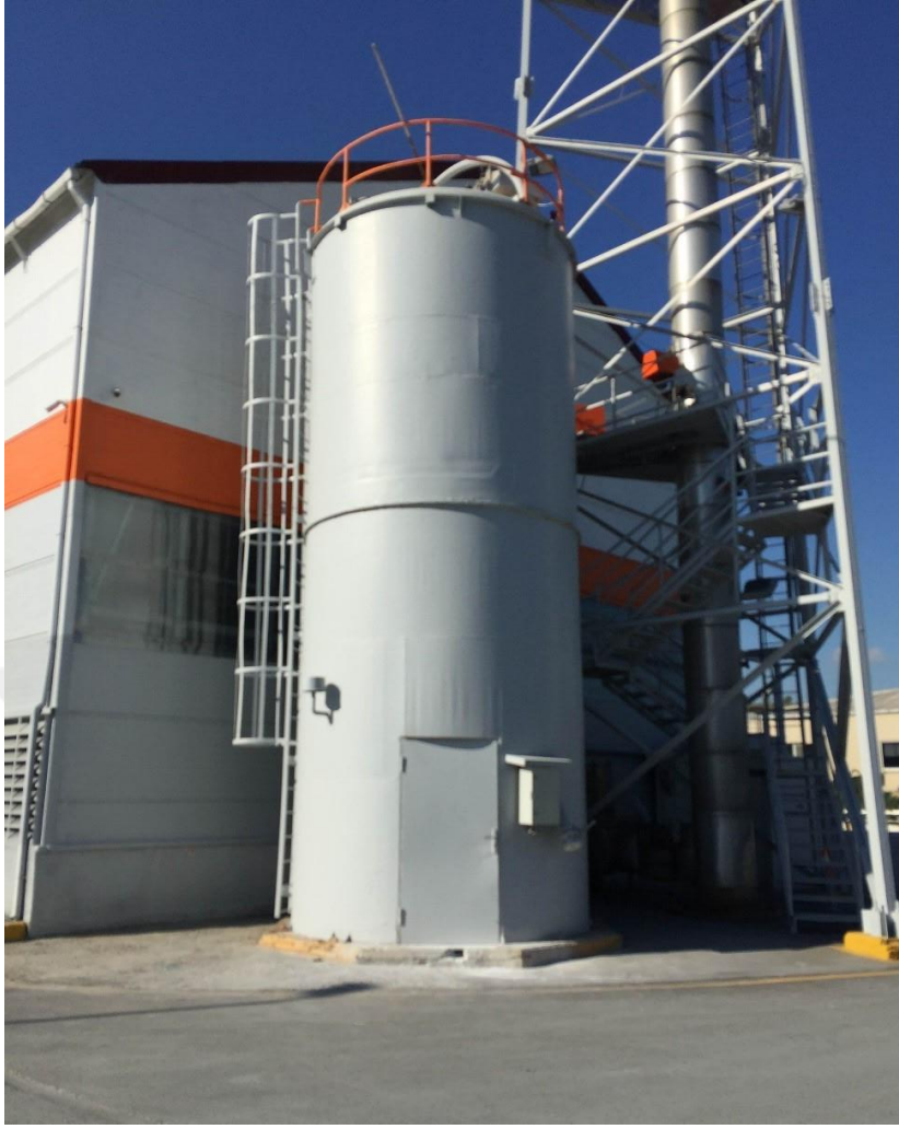
Şekil 2.13 Kireç Silosu Ünitesi
