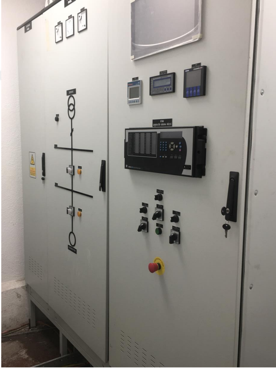
Şekil 6.21 Jeneratör kesici ve senkronizasyon panosu
