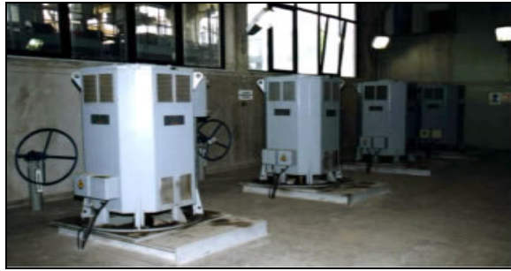
Şekil 4.16 : Ana Atıksu pompaları
