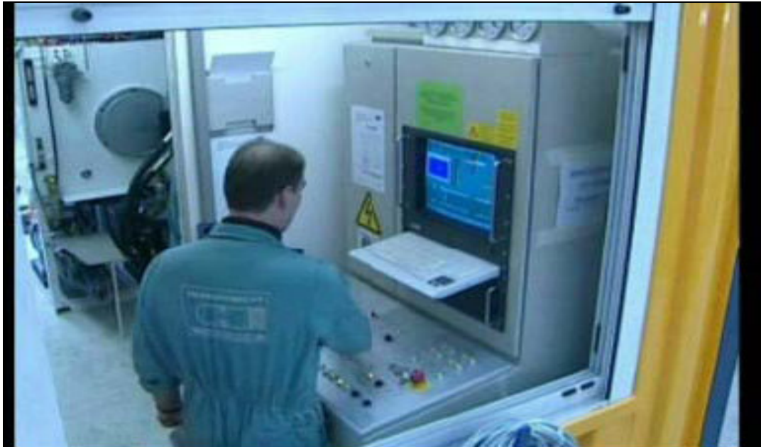
Şekil 4.4 : Kontrol kabini ve kontrol paneli
