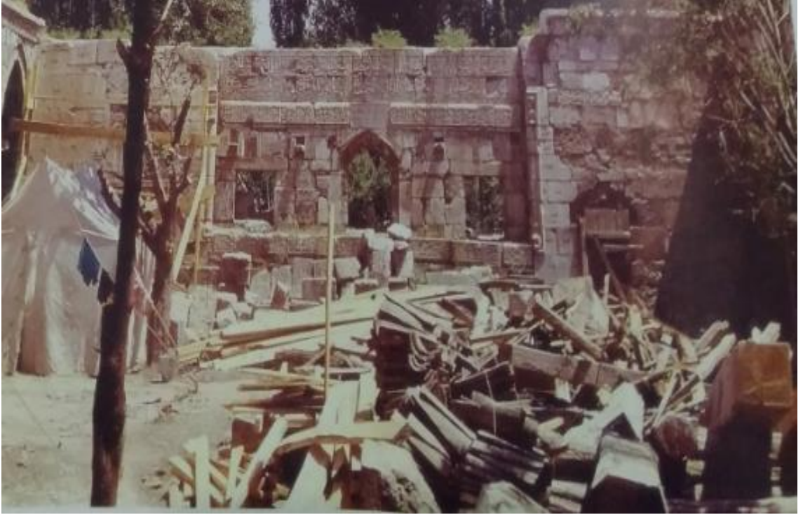
SİVAS GÖK MEDRESE DOĞU EYVANI ÖRÜLEN DUVAR-FOTOĞRAF 6
