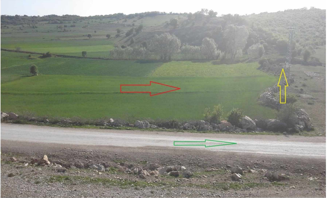
(Resim:26) Çakır Köyü Hitit Barajı; kırmızı ok ile gösterilen alan su rezervuar alanı, yeşil ok ile gösterilen alan günümüzde inşa edilen ve barajın şev duvarını keserek tahrip eden yol, sarı ok ile gösterilen alan şev duvardır. (Ayşe Üke, arşiv)
