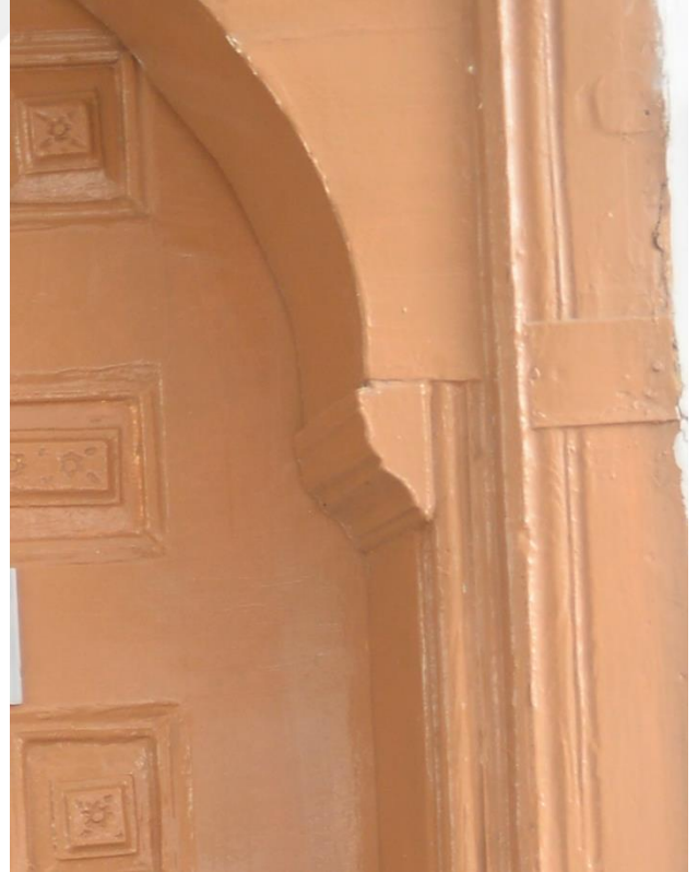
Fotoğraf 5.9.2.1: Kulaksız Camii Kapısı Kemer Desteđi.
