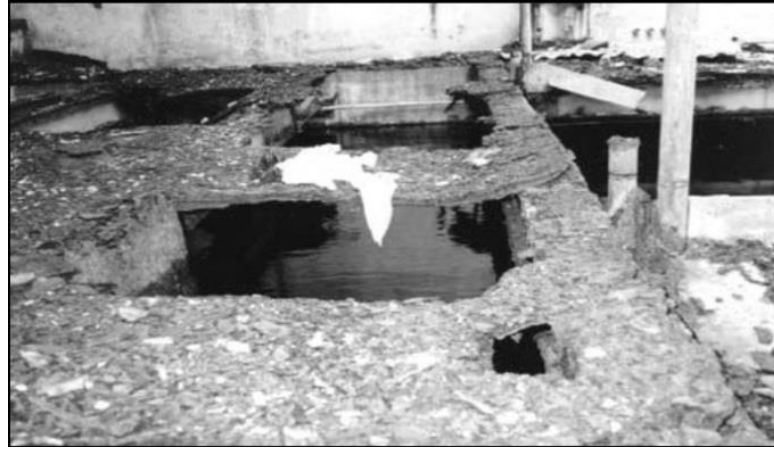
Resim 2.1. Çelik yapı üzerine üniform korozyon saldırısı (Anonim, 2008)
