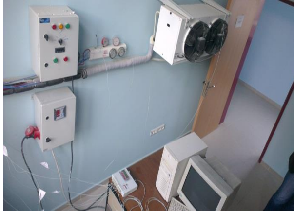
Resim 3.1. Isı pompası sisteminin iç ünitesi
