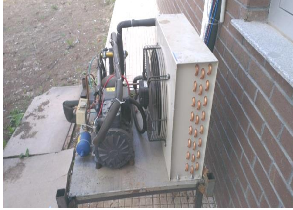
Resim 3.2. Isı pompası sisteminin dış ünitesi
