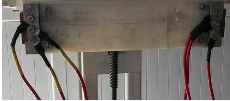
Resim 3.6. DC güç kaynağının bağlantı elemanları
