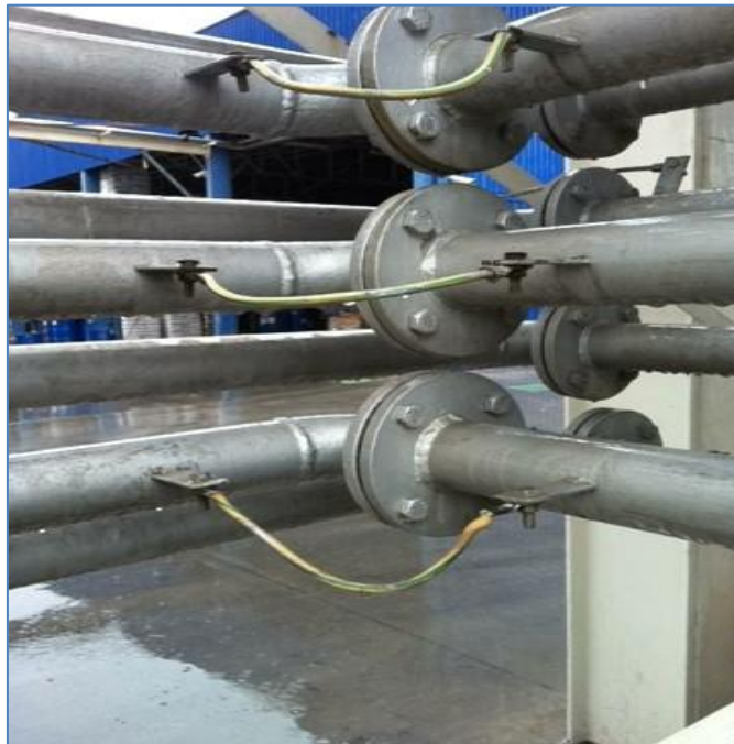
Şekil A.8.5 : Hammadde transfer borularının flanşlar arası iletken kablo ile statik yük birikimi önlemi
