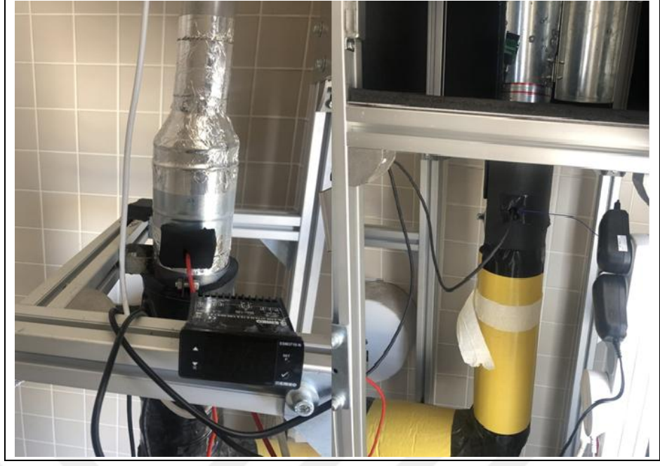
Şekil 3.9: Isıtıcı (Sol), Isı ve Nem Sensörü (Sağ)
