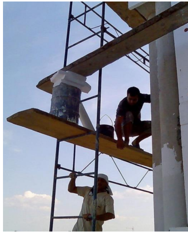
Resim 18. Uygunsuz İskele Kullanımı
