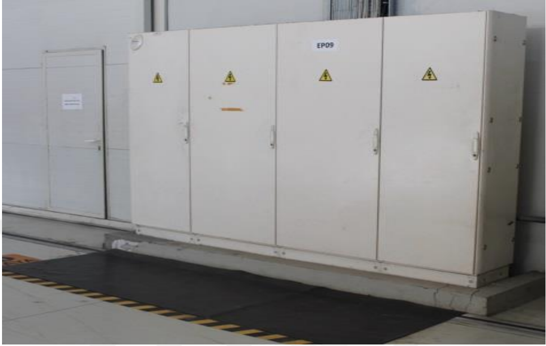
Resim 100: Elektrik dolapları önündeki anti – statik paspas
