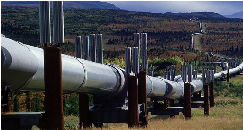
Resim 30: Alaska Petrol Boru Hattı günde 2 milyon varil petrol aktarmaktadır.
