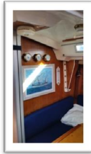
Resim-5.16. Özel tekne yaşam alanında yangın ihbar sistemi uygulaması (17 Aralık 2016 tarihinde çekilmiştir)
