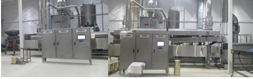
Şekil 2. 20: Kızartma ve soğutma ünitesi
