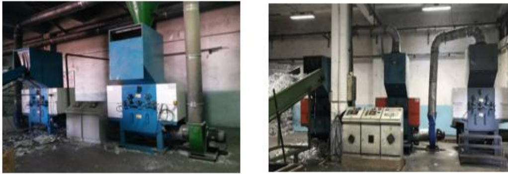
Şekil 7.8. Tesis □ (Uşak) Kırıcı Parçalayıcı Ünitesi
