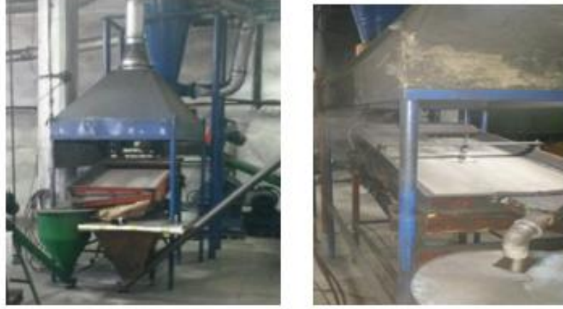
Şekil 7.12. Tesis 1 (Uşak) Elek Sistemi
