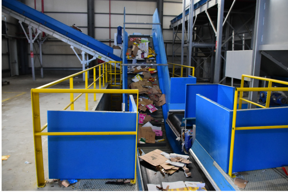
Şekil 14. Pendik Belediyesi ambalaj atık ayrıştırma tesisi iç görünümü [5]
