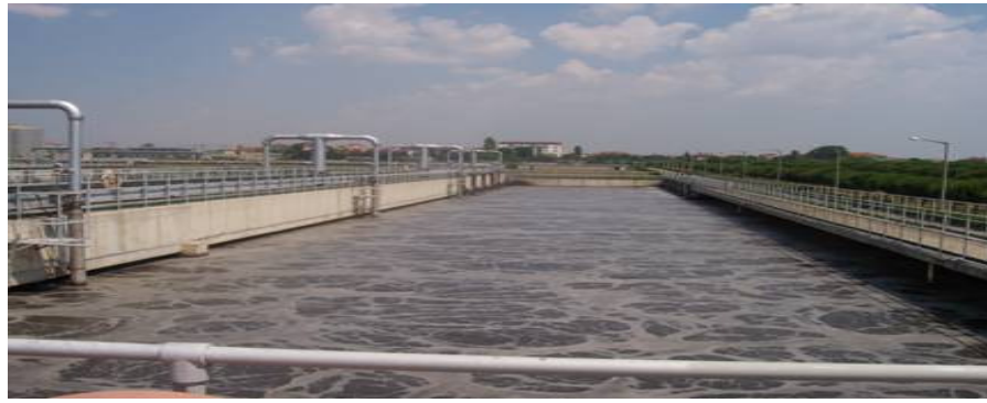
Şekil 2.3. Tuzla Biyolojik Atıksu Arıtma Tesisi havalandırma havuzu
