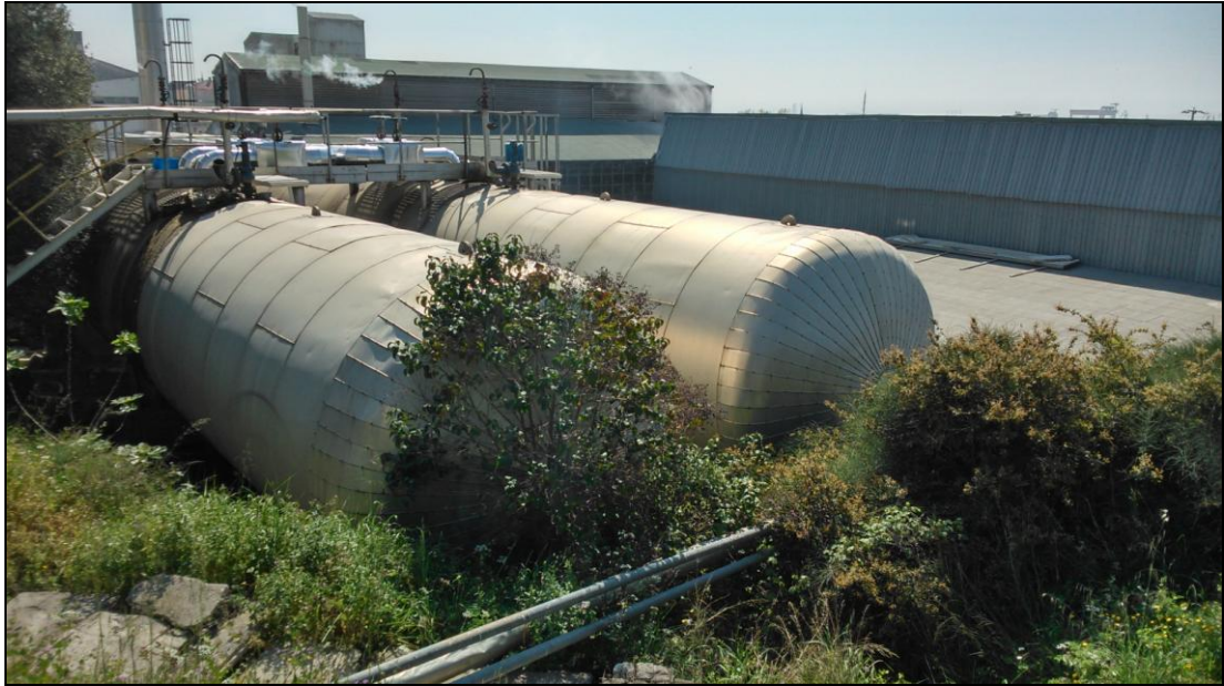
Şekil 2.6: 2 adet 80 m 3 hacmindeki akü tanklarından genel görünüm.
