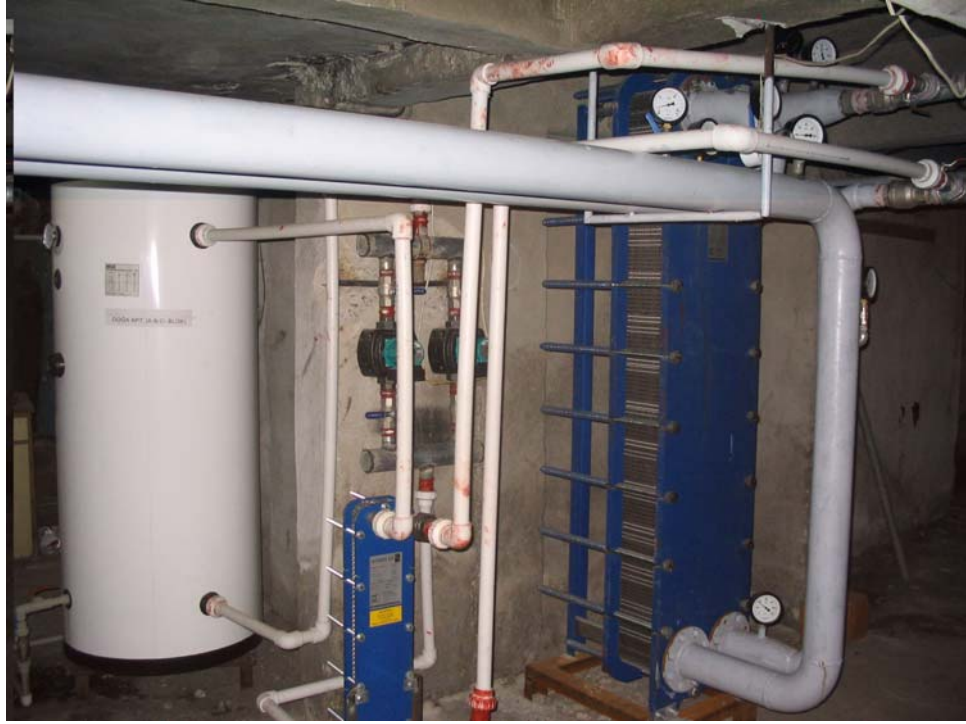
Şekil 4.9 Edremit JMIS’de Bina Altı Eşanjörlerinden Bir Görünüm
