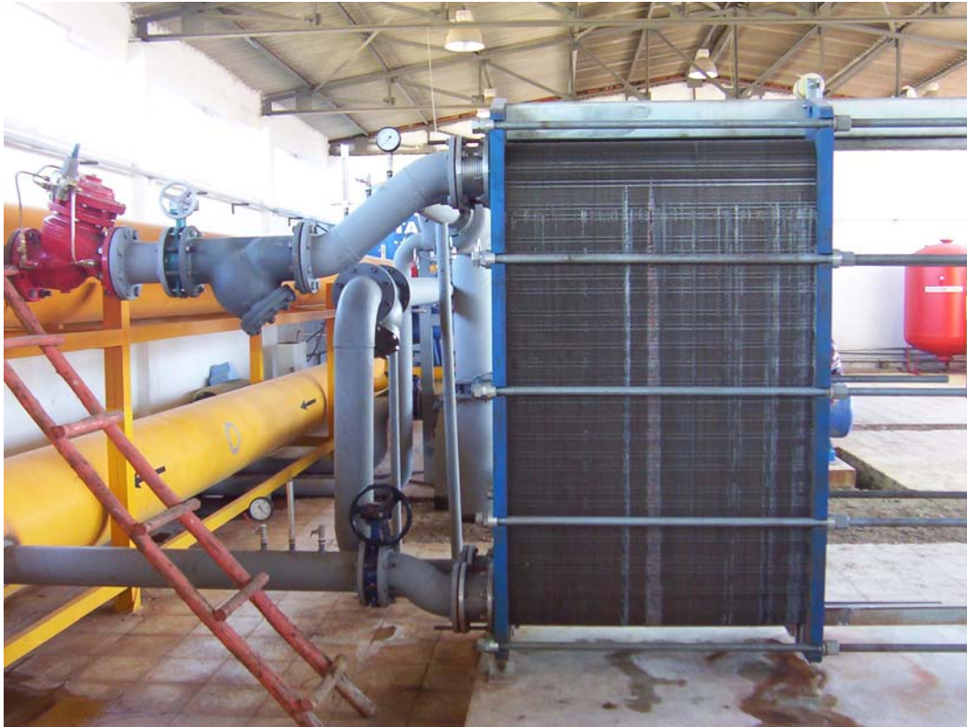
Şekil 4.5 Bigadiç JMIS'in Isı Merkezindeki Eşanjörler
