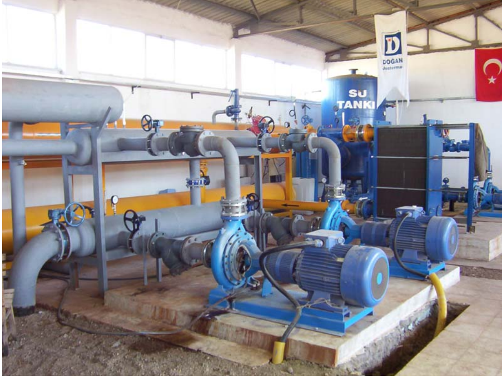
Şekil 4.4 Bigadiç JMIS'in Isı Merkezindeki Sirkülasyon Pompaları
