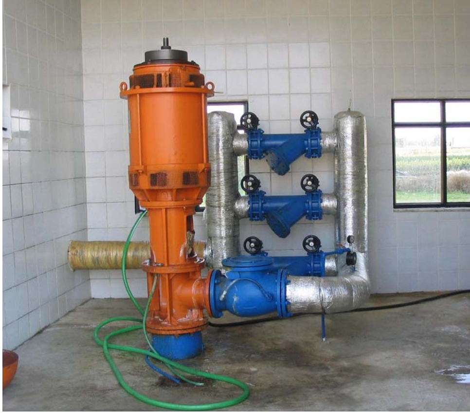
Şekil 4.8 Edremit JMIS’de Kuyu Başı Pompalarından Bir Görünüm
